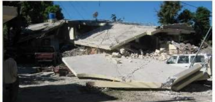
Bâtiment effondré en 2010
