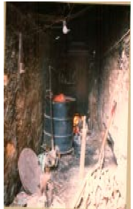
Système de chauffage de l'eau dans les dry-cleanings
