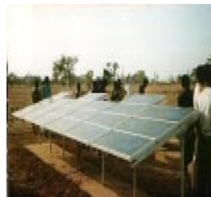
Modules photovoltaïques pour l'alimentation d'une pompe
