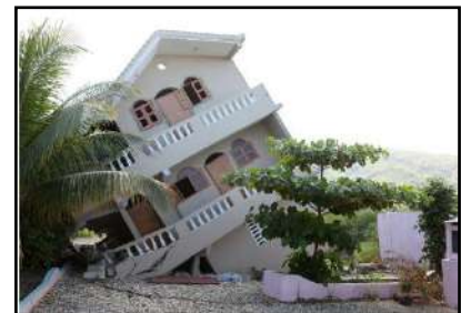
Effet de la liquéfaction – Exemple de poinçonnement du sol de fondation à Léogâne (Haïti), séisme du 12 janvier 2010 (M = 7.0)
