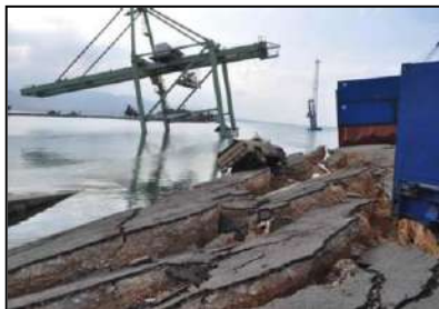
Effet de la liquéfaction – Glissement latéral observé sur le port de Port-au-Prince (Haïti) suite au séisme du 12 janvier 2010
